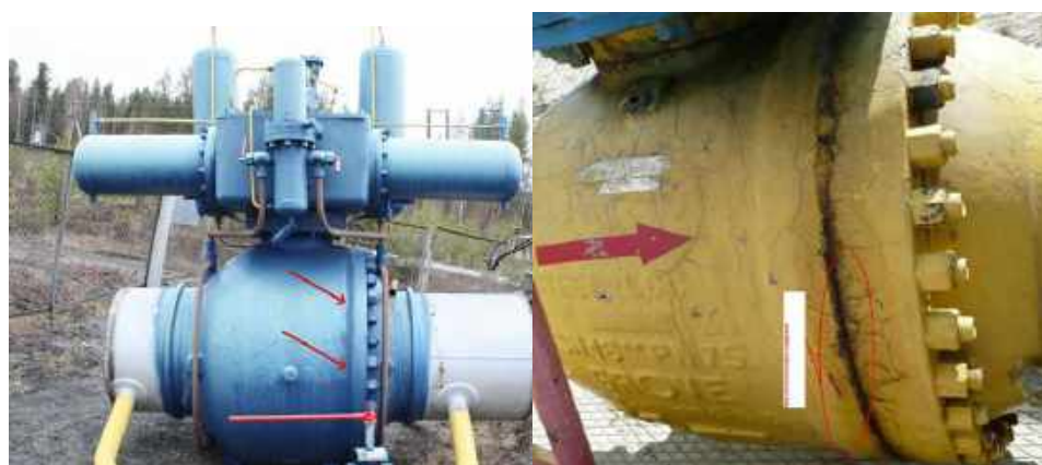
Рисунок 6 – Нарушение герметичности корпусных соединений крана, утечка по разъему корпуса
