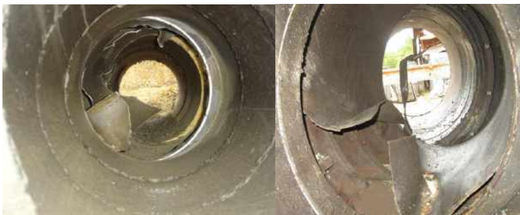
Рисунок 5 – Разрушение внутренней обечайки шаровой пробки, отрыв пластин внутренней гильзы шара
